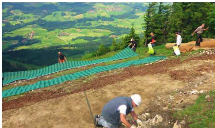
Ausrollen der Securatek-Schutznetze auf der ganzen Länge, um das Material über Nacht entspannen zu lassen.
